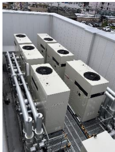
天然ガス コージェネレーションシステム
