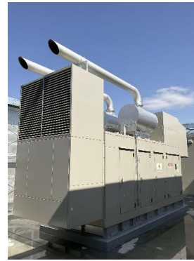
非常用自家発電設備（拡大）
