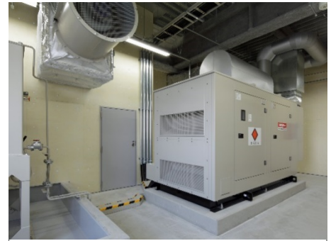
▲非常用発電機
