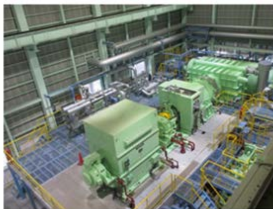
▲排熱発電設備 タービン発電機
