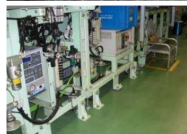
▲倒壊対策した機器類
