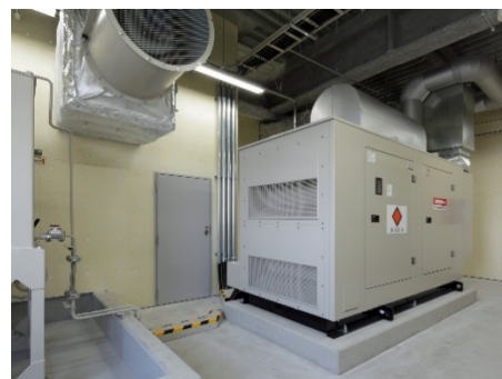
▲非常用発電機
