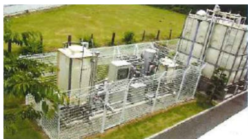
▲地下水膜ろ過システム
