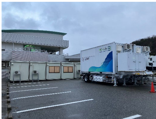
▲ 志賀町立富来病院に設置された医療コンテナ
