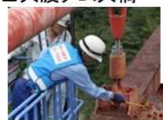
ケーブルの力 バー部分の腐食
