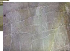
下部工のひび割れ
