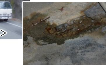
覆工コンクリートの剥落・貫通ひびわれ
