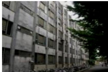
落下の危険がある外壁
