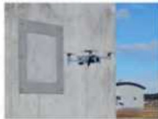
ドローンによる損傷把握
