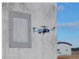
ドローンによる損傷把握
