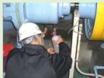
潤滑油診断によるポンプの 状態監視状況
