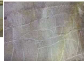
下部工のひび割れ
