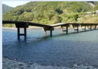
2017年11月に岩間沈下橋の一部がV字崩壊
