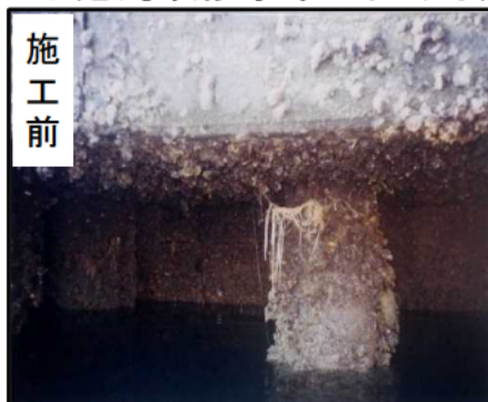
鋼管杭が塩害により腐食
