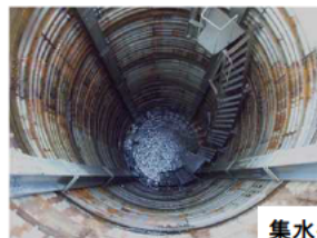
集水井内の劣化
