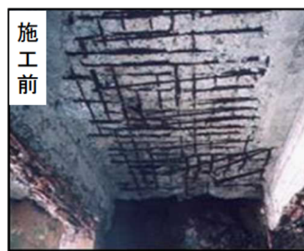
栈橋裏面の鉄筋コンクリートが 塩害により腐食
