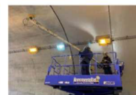
レーダーを利用したトンネル覆工の損傷把握
