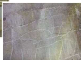
下部工のひび割れ
