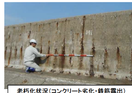
老朽化状況(コンクリート劣化・鉄筋露出)
