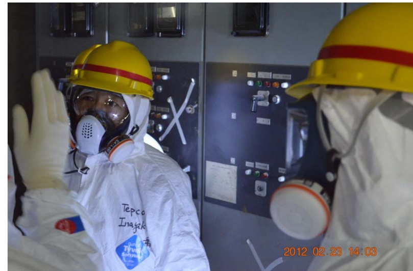
補助共用建屋 2号 D/G電気品室
