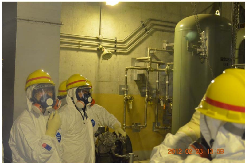
補助共用建屋 非常用ディーゼル発電機室機関始動用空気タンク
