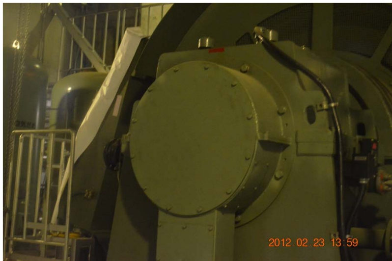
補助共用建屋 非常用ディーゼル発電機
