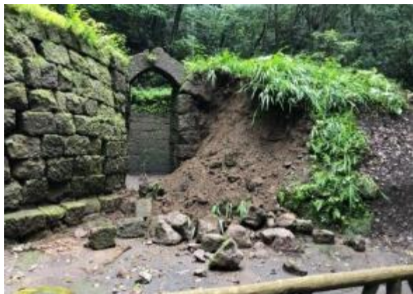
写真1 被災状況(2019.6.28撮影)
