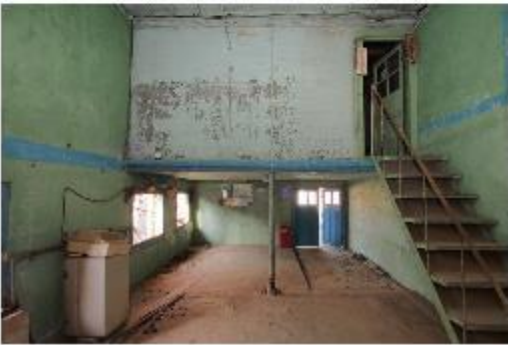
◎乾燥室下の落下防止装置を脱衣室より見る
