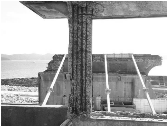
写真 2-4-102 爆裂 庇C通り2柱
