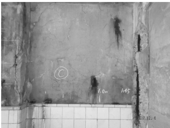
写真 2-4-98 爆裂、腐食 1階A通り2柱
