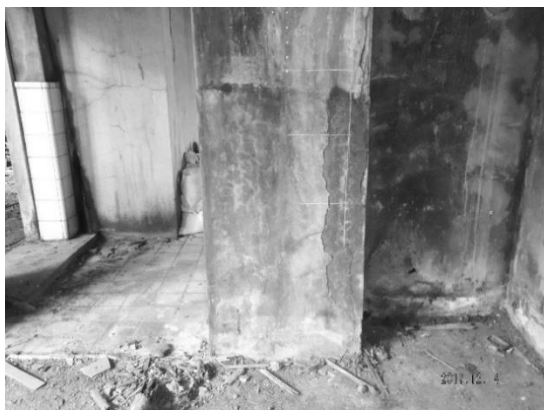
写真 2-4-97 亀裂 1階C通り2柱
