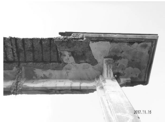
写真 2-4-103 爆裂 庇上裏面
