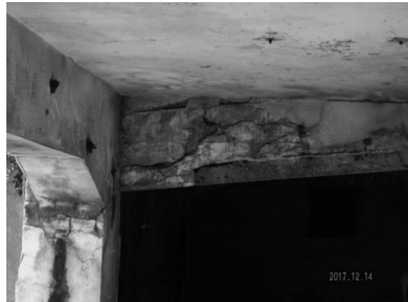
写真 2-4-101 亀裂、剥離 2階梁 2G3A
