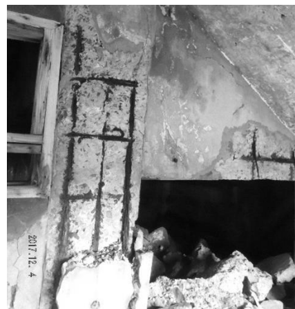
写真 2-4-99 爆裂、腐食 1階B通り1柱
