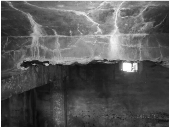
写真 2-4-100 爆裂、腐食 2階梁 2G1Aa
