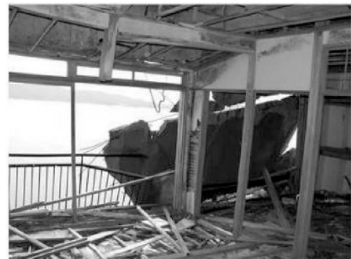
写真 2-4-124 室内造作物の劣化状況
