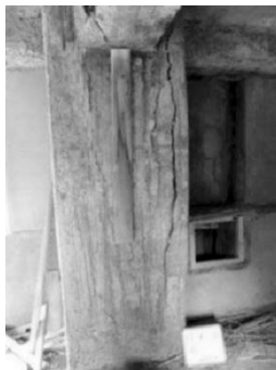
柱 損傷度Ⅲ
