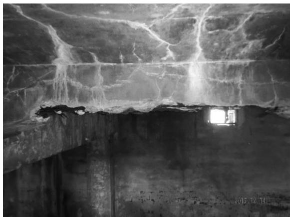
写真 2-4-100 爆裂、腐食 2階梁 2G1Aa
