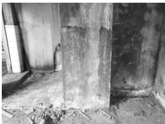
写真 2-4-97 亀裂 1階C通り2柱
