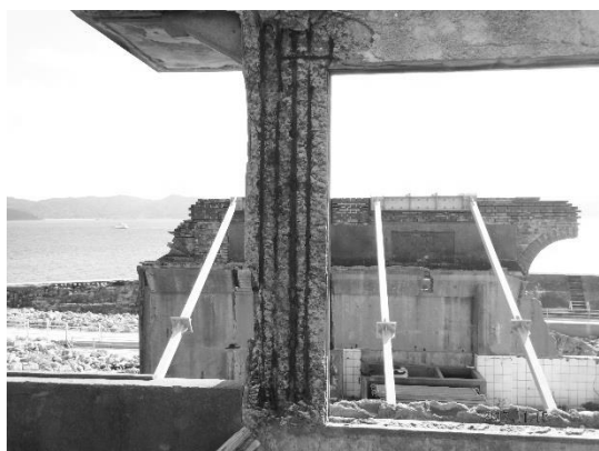
写真 2-4-102 爆裂 庇C通り2柱
