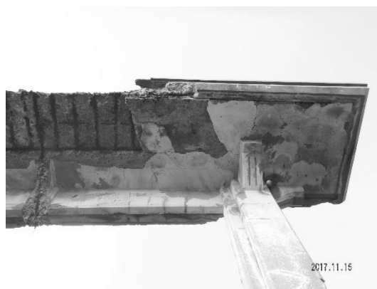
写真 2-4-103 爆裂 庇上裏面
