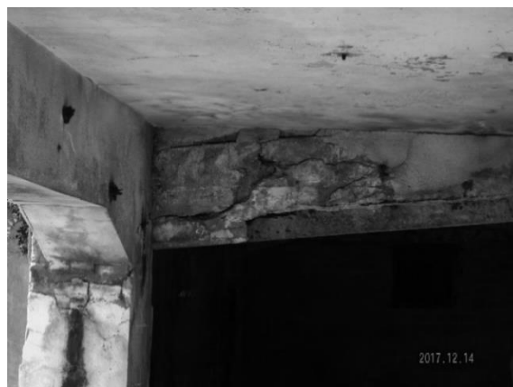
写真 2-4-101 亀裂、剥離 2階梁 2G3A
