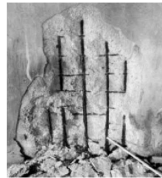
壁 損傷度Ⅳ
