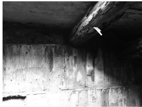
写真 2-3-68 3-A04_東壁上部
