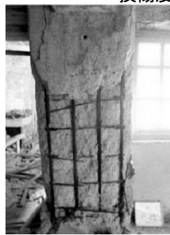
柱 損傷度Ⅳ
